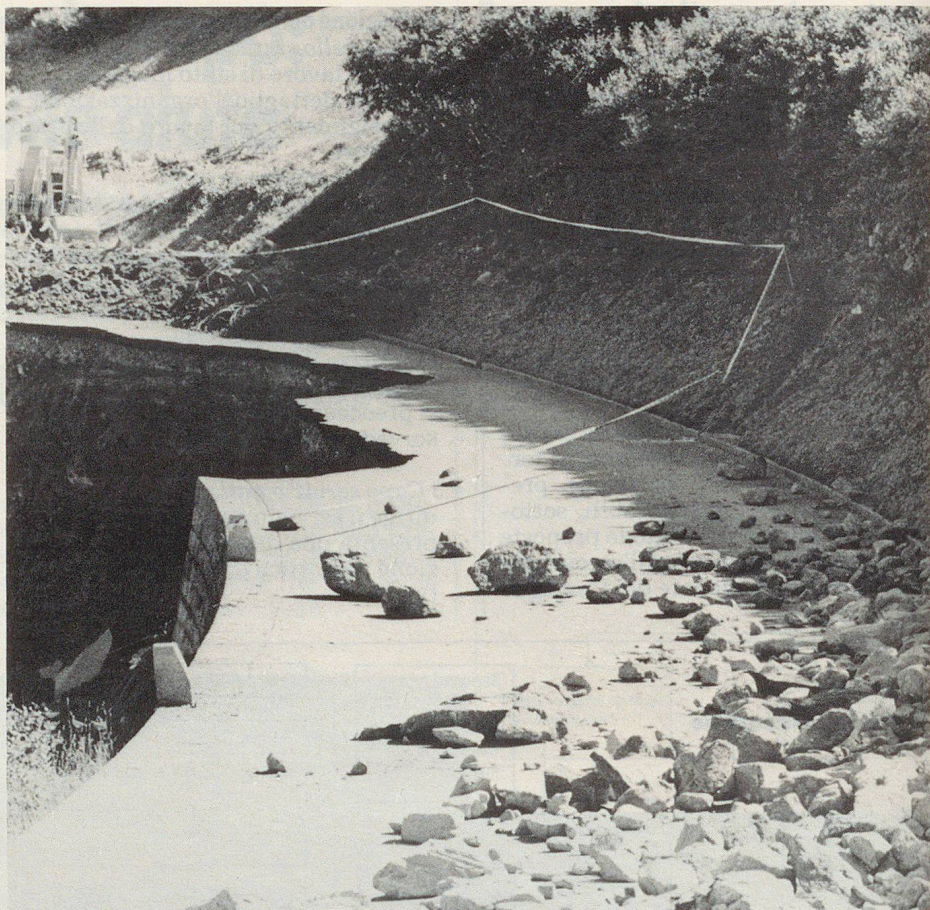
Strada devastata tra Andermatt e Realp.
