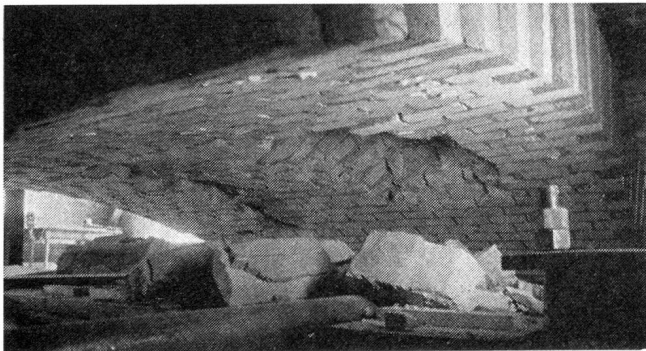
Abb. 15. Absprengungen auf der Unterseite eines Kalksandsteingewölbes infolge einer Einzellast auf dem Scheitel
