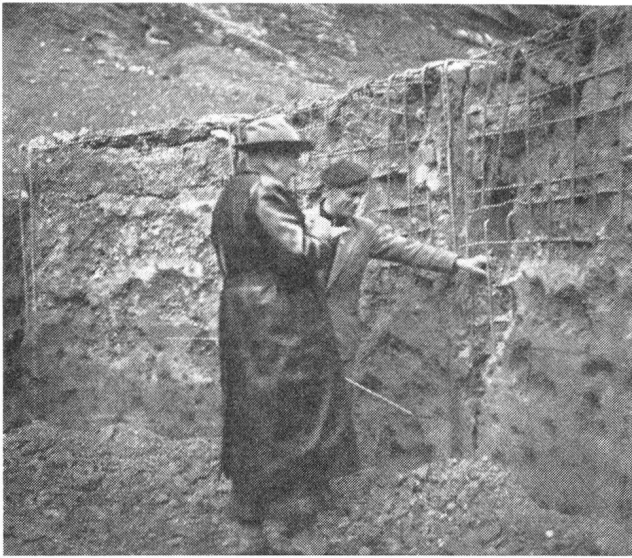
Abb. 2. Durch Bombensplitter erodierte Betonwände
