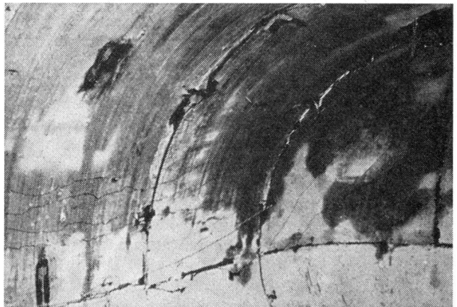
Abb. 13. Zustand einer 7 cm dicken armierten und gebogenen Wand einer Betonschale nach der Explosion einer 50-kg-Bombe in 4 m Abstand auf der Tiefe der Sohle
