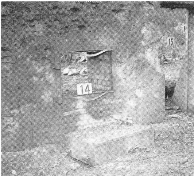
Abb. 3. Durch die Wirkung von Bombensplittern auf die Scharnierrollen abgefallener Panzerbetondeckel
