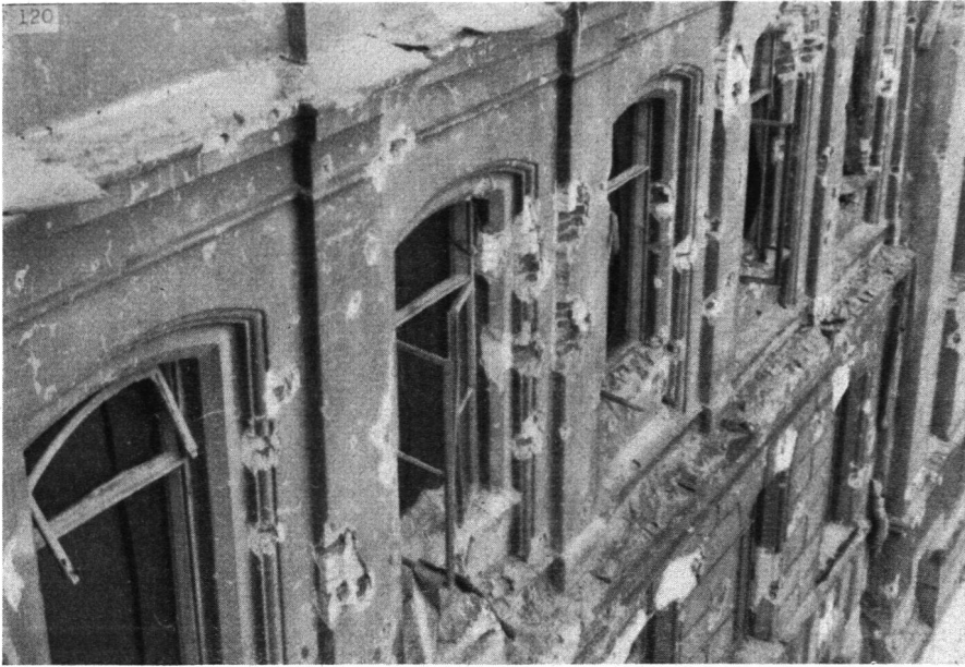
Abb. 5. Unter Splitterwirkung «ausgewaschene» Fassade.
