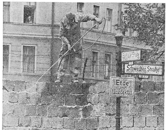
An der Sektorengrenze in der Bernauer Strasse wird die Mauer «verschönert». Ostberliner Arbeiter stehen auf der Mauer und spritzen mit einem langen Rohr weisse Farbe auf die nach Westberlin weisende Seite.
