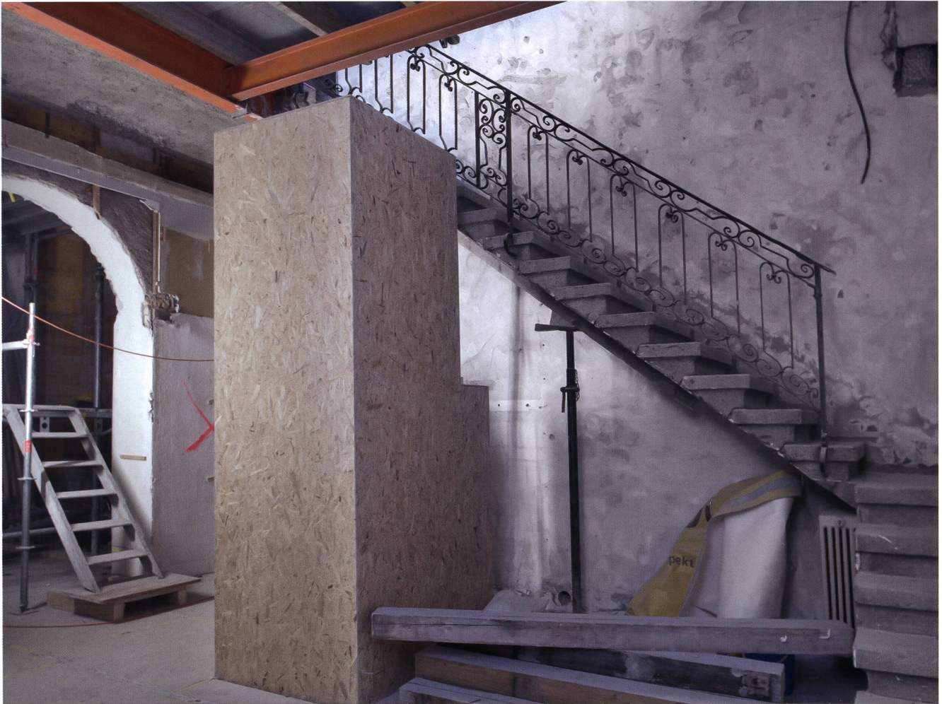
Sanierung des Westflügels im Landmuseum Zürich, Raum 20 (alte Nummerierung: Raum XXXII). Foto: Schweizerisches Nationalmuseum, Zürich.
