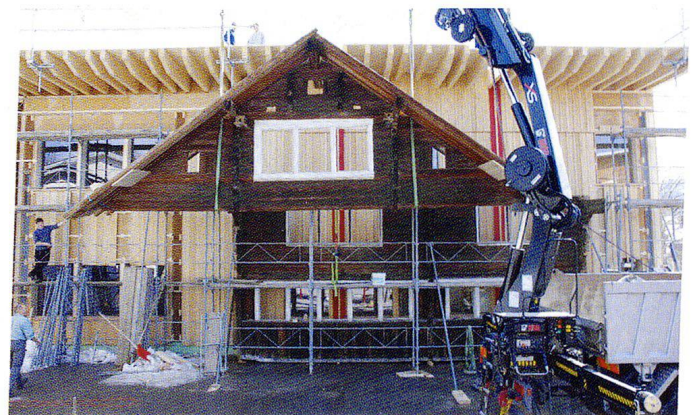
Abb.44–47 Demontage des Hauses Egger in Unterwolfhalden und Translozierung der Bauteile zur Werkhalle des Holzbetriebes Nägeli nach Gais.
