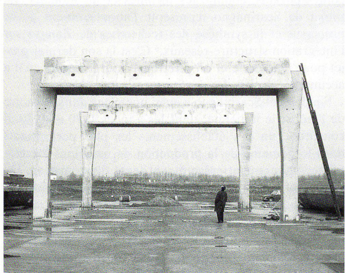
Fig.11 L'ensemble industriel de Scarmagno en cours de construction, vers 1968, Marco Zanuso regarde les premiers éléments de la structure en place sur le site.
