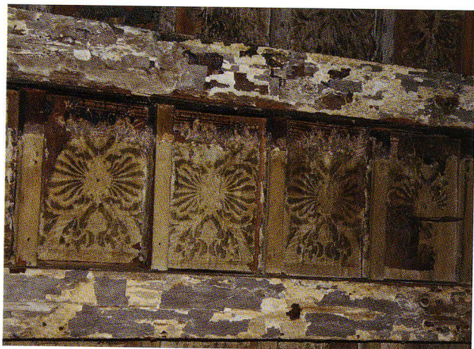
Fig. 7 Détail avant l'intervention de 2009.
