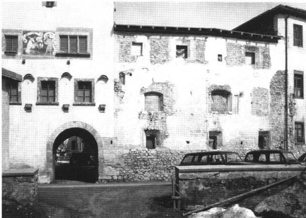
Abb. 8 Müstair, Kloster St. Johann. Südtrakt, Fassade nach der Untersuchung. Fenster aus dem 19. Jahrhundert sind zugemauert, ältere wieder geöffnet.
