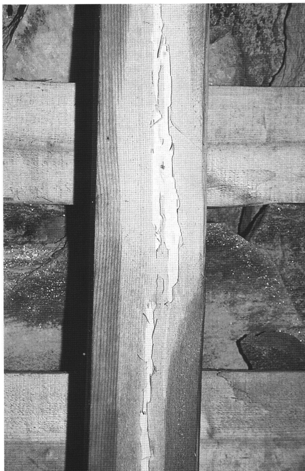
Fig. 1 Correntino del tetto della chiesa di Mairengo (Ti) con le gallerie scavate dal capricorno ( Hylotrupes bajulus ), un parassita che attacca esclusivamente il legname delle conifere.
