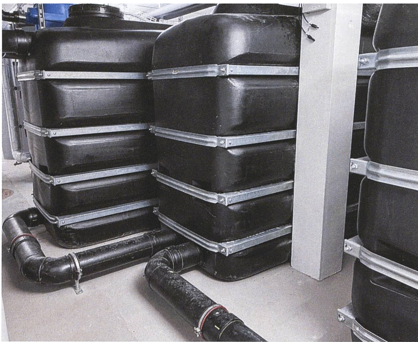
Regenwassertanks in der neuen Siedlung Bachwiesen der BG Zurlinden in Zürich Albisrieden: Die Toiletten von mehr als 50 Wohnungen werden mit Regenwasser versorgt.
