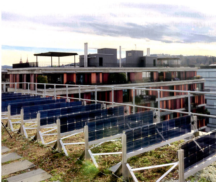
Senkrechte PV-Module und Gründach: die Pilotanlage auf dem Dach der Alterssiedlung Eichgut in Winterthur.
