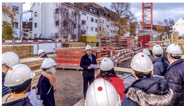
Co-Präsident Kurt Ammann begrüsst die Anwesenden zur Grundsteinlegung am Ilanzhof V. Die Baugenossenschaft Freiblick erstellt hier zeitgemässen Wohnraum für Familien und Senioren.
