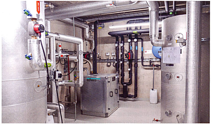
ewz-Projektleiter Pascal Leumann erklärt die verschiedenen Anlagen. Auf dem Bild links sind die schwarzen Erdsondenanschlussleitungen zu sehen, oben Warmwasserspeicher, Wärmepumpe und Pufferspeicher (von links).
