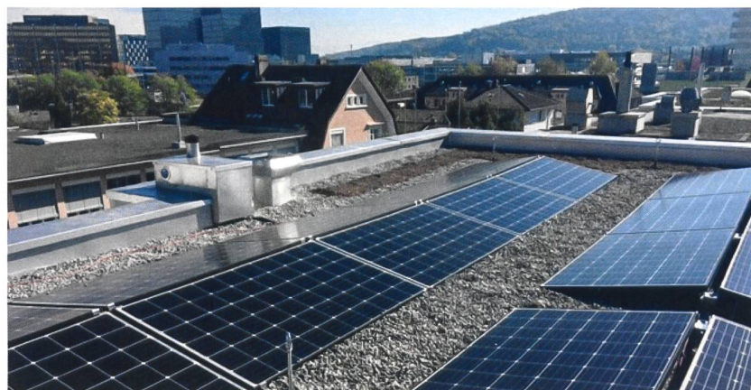
Auf dem Dach findet sich eine 46 Quadratmeter grosse Photovoltaikanlage.
