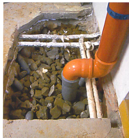
Eine Sanierungsmöglichkeit ist die punktuelle Absaugung von Radon («Radonbrunnen»).
