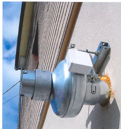
Ein aussenliegender Ventilator erzeugt einen leichten Unterdruck unter der Bodenplatte.
