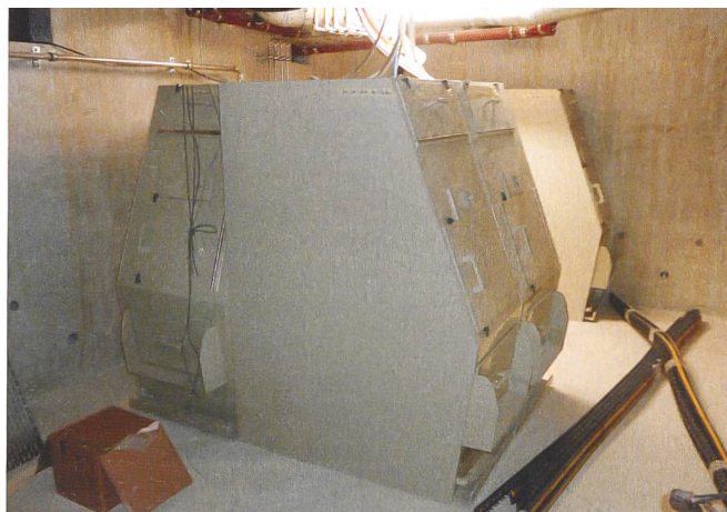
Hier wird aber nicht mit Wasser gespült. Vielmehr landen Fäkalien und Urin über ein Rohr direkt in einem Kompostierbehälter im Keller.
