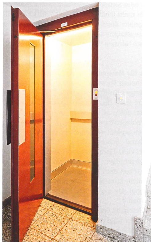
Kabinenabschlusstüren sollten auf Empfehlung des VSA auch bei bestehenden Aufzügen eingebaut werden, um das Unfallrisiko zu senken.
