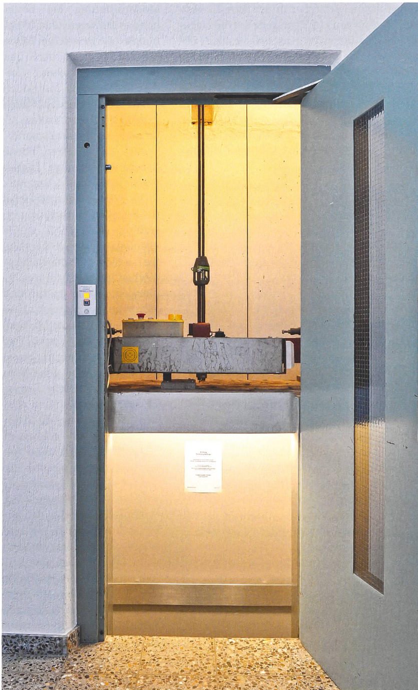
Alte Aufzüge bergen Gefahren. Dank der neuen Normen sind künftig auch Servicefachleute weniger unfallgefährdet.
