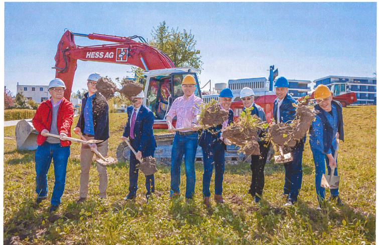
Vor rund 40 Gästen griffen Vertreter von BGZ, Gemeinde und Projektbeteiligten zum Spaten.
