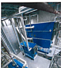
Titelbild: Heizzentrale des Fernwärmenetzes Biel Battenberg: im Hintergrund der acht Meter hohe Winterofen, davor der deutlich kleinere Sommerofen. Gespeist werden sie mit Holzsnitzeln.
