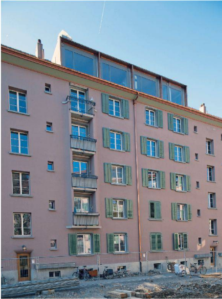
Blick in den Innenhof nach abgeschlossener erster Etappe. Hier wurden Fenster ersetzt und Fassaden erneuert, während es in der zweiten Etappe auch Balkonanbauten geben wird.
