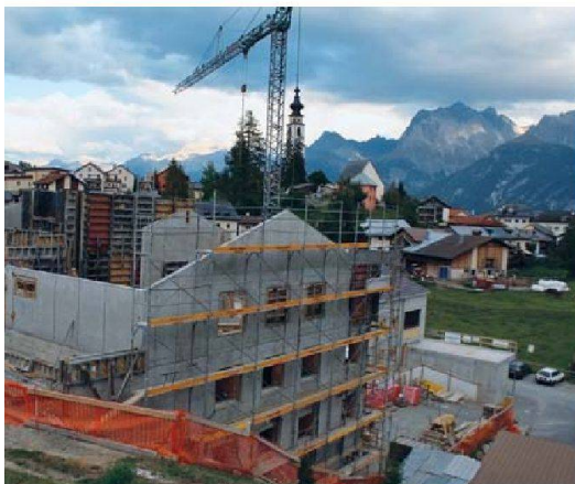
In Ftan (GR) führte der touristische Wohnungsbau zu Preisdruck und Mangel an Mietwohnungen. Deshalb gab die Gemeinde der neu gegründeten Genossenschaft Chasa Reisgia Land im Baurecht ab, um dort bezahlbaren Wohnungen für die lokale Bevölkerung zu schaffen.
