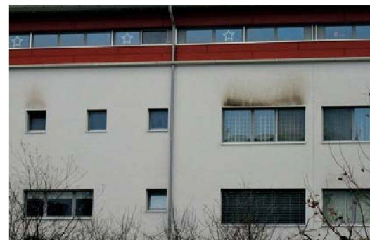
Fehlende oder kleine Dachvorsprünge begünstigen die Algenbildung. Oft findet sich Algenbefall auch oberhalb von Kipfenstern, weil die warme Luft auf der Fassade kondensiert.
