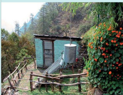
Toilette und «Hot-Shower» mit Sonnenkollektoren im Langtang.
