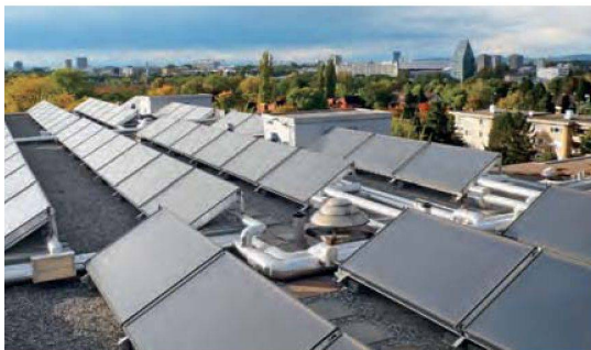
Die Solaranlage zur Warmwasseraufbereitung bedeckt eine Dachfläche von 200 Quadratmetern.
