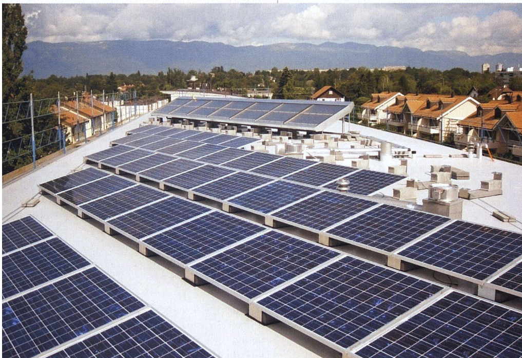
Der Neubau der Genfer Baugenossenschaft Codha zeichnet sich unter anderem durch seine 100-Quadratmeter-Fotovoltaikanlage aus.
