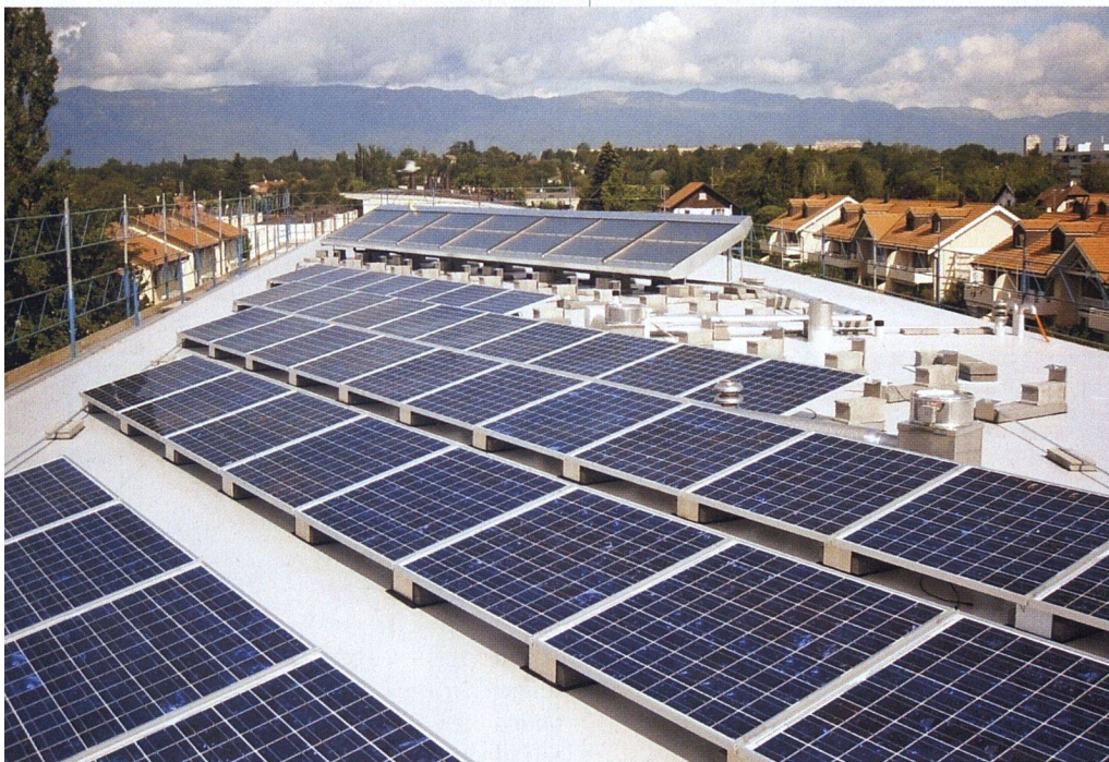
Der Neubau der Genfer Baugenossenschaft Codha zeichnet sich unter anderem durch seine 100-Quadratmeter-Fotovoltaikanlage aus.
