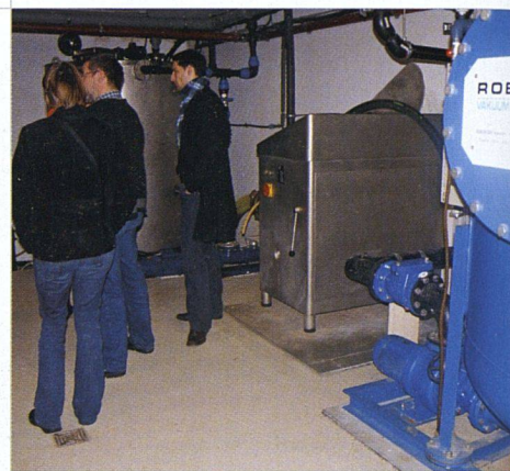
Organische Siedlungsabfälle gelangen in der Siedlung Flintenbreite in ein Mahlwerk (hinten, grau), WC-Abwässer in eine Vakuumanlage (rechts, blau).
