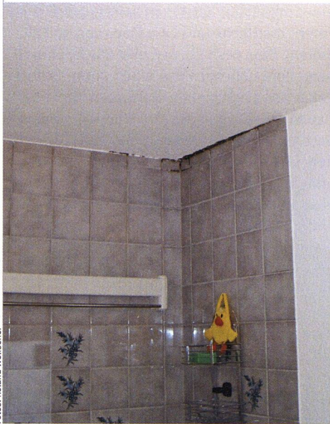
Feuchtigkeitsschäden treten in Wohnräumen häufig in auskühlenden Ecken auf.
