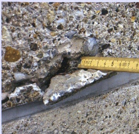
Oft werden Armierungseisen zu wenig tief eingebettet, so dass Korrosionsschäden auftreten.
