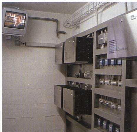
Über eine Kopfstation werden mehrere Haushalte einer Siedlung mit Fernsehprogrammen versorgt.
