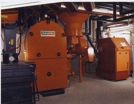
Das mächtige, 100 Kubikmeter fassende Holzschnitzelsilo ist in der spiralförmigen Zufahrt zur Tiefgarage untergebracht.
