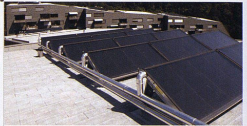
Auf den Dächern der Bauten sind je 112 Quadratmeter Solarkollektoren installiert, die an sonnigen Tagen das Warmwasser erwärmen.
