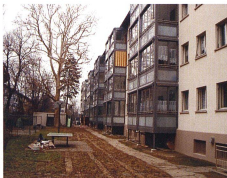
Beispiel eines beheizten Balkonanbaus: Im Rahmen der kompletten Sanierung der Mehrfamilienhäuser der Wohngenossenschaft Kaysersbergerstrasse in Basel wurden insgesamt 96 Balkone zu wohnraumerweiternden Wintergärten umgebaut (Architekt/GU: BfR AG; Unternehmer: Solarlux AG).
