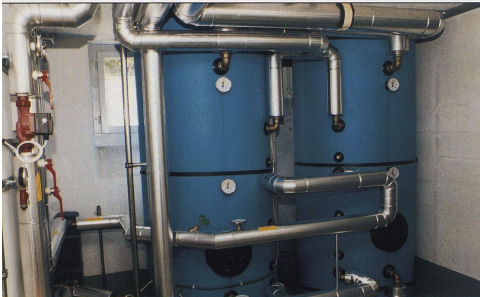
Speicheranlage für das solar vorgewärmte Wasser im Keller der Siedlung Herzogenmühle. Rund ein Viertel der Kosten konnte mit Fördergeldern der Aktion «Züri Solar» gedeckt werden.
