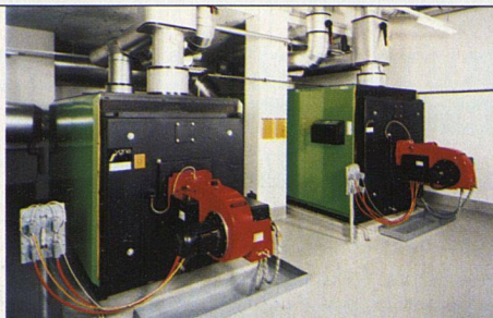
Moderne Heizzentrale für Wohnüberbauung mit «Multiflam»-Monoblockbrenner.
