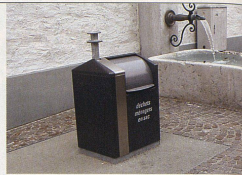
Tiefsammelstelle mit oberirdischen Einwurfsäulen. Der Sammelcontainer befindet sich in einem Betonschacht im Boden.
