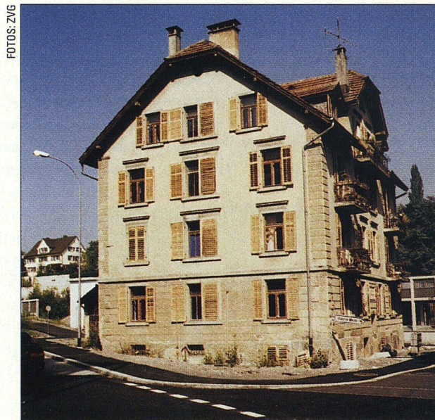
Lärmgeplagt und sanierungsbedürftig: das Haus an der Maihofstrasse in Luzern.
