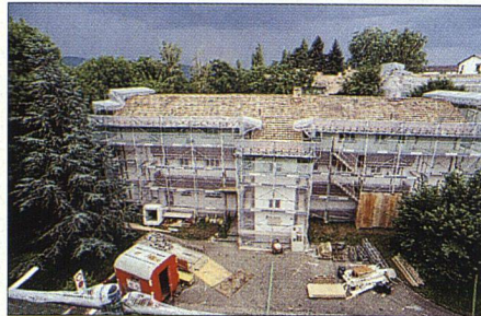
Für die Baustelleneinrichtung ist nur beschränkt Platz; die Zufahrtswege sind für Lastwagen sehr eng.
