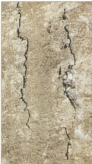
Entstehung von Rissen
