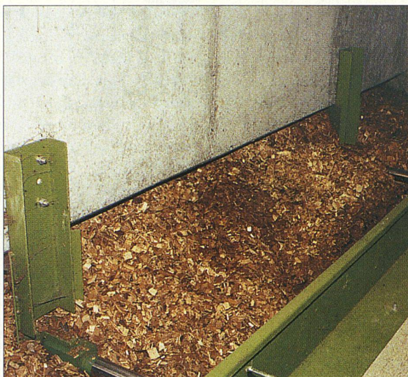
Arbeitserleichterung am «Sonnenberg»: Wenigstens muss niemand Holzschnitzel schippen, sie werden hydraulisch nachgeschoben.
