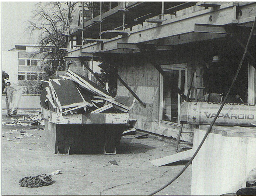
Beim Abbruch müssen mehrere Mulden bereitstehen, damit das anfallende Material richtig sortiert werden kann: brennbar/nicht brennbar, unschädlich für den Boden ...
