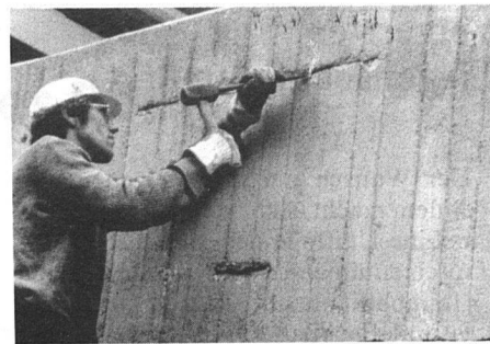
Freilegen von korrodiertem Bewehrungsstahl.
