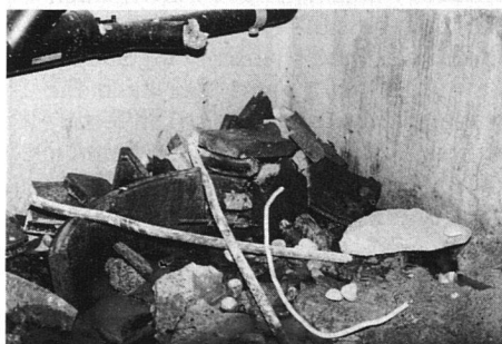
An die Stelle der alten gefrässigen Heizungen...
