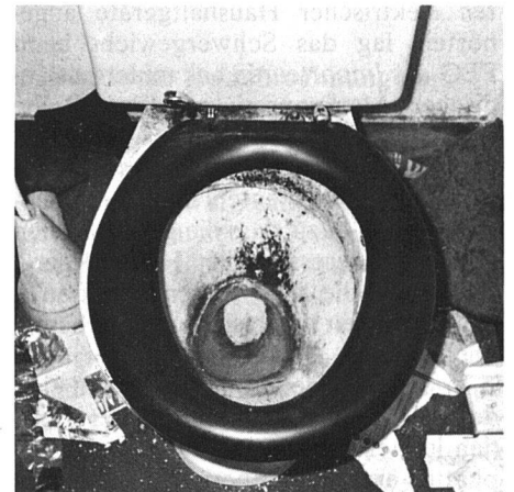
Unten ein Detail aus Bad/WC: Kommentar überflüssig
