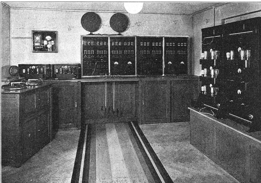
Verstärkerzentrale mit Verteilertableau und Mess-Instrumenten, von wo aus die Verteilungen zu den Abonnenten gehen
