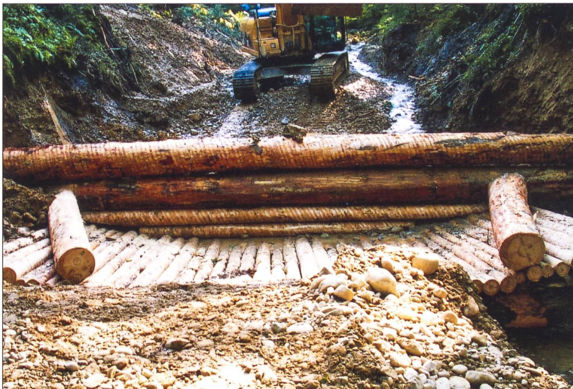
Im Napfbergland ist die Ufersicherung ein wichtiger Auftrag, hier bei der Verbauung der Änziwigger in der Wiggernbütte.
