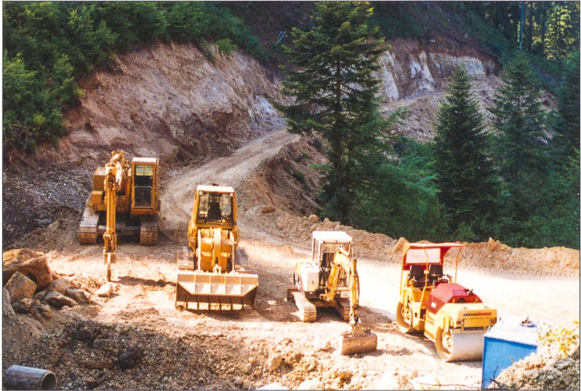
Eine moderne Bauunternehmung muss unterschiedliches Gerät einsetzen können. Im Napfbergland arbeitet die Zettel AG mit Maschinen für jede Aufgabe; Strassenbau Niespel in Luthern Bad um 1990.
