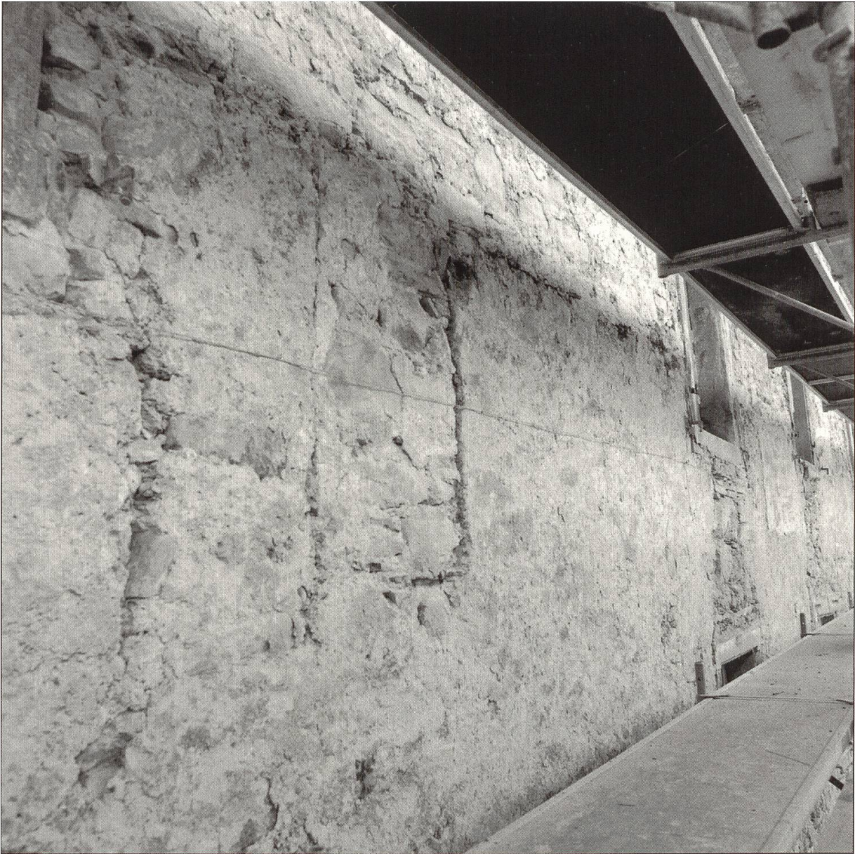
Abbildung 14: Westfassade des Hauses Obertor 2 (Wirtschaft 'Zum Stern'), das gegen die westliche Wehrmauer gelehnt ist. Zehn Meter über dem Boden, im Bereich der Fenster des dritten Obergeschosses, haben sich noch Zinnen der Wehrmauer erhalten, die ursprünglich offen waren und durch die der angreifende Feind beschossen werden konnte.
