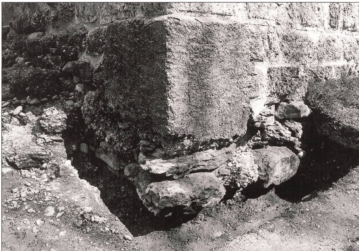
Die Fundamentsteine der Südwestecke auf der erodierten Moränenunterlage. Die aus früheren Zeiten sichtbare Reparatur hat wohl die durch die Entfernung eines Ecksteines entstandene Lücke schliessen müssen.
