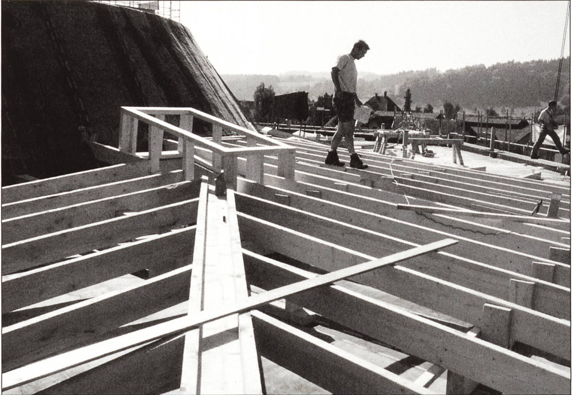
Bild oben: Die Tragkonstruktion ist im Holzbau gehalten (Ebene eins mit Verlängerungsbauten Lichtschalen).
