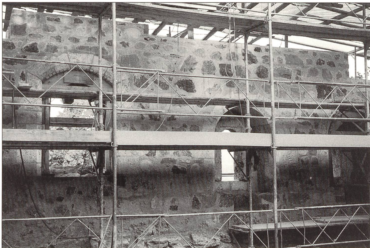
Das oberste Stockwerk der Ostmauer im endgültigen Zustand und als Beispiel für die weiteren Arbeiten. Foto: Ferdinand Andermatt
