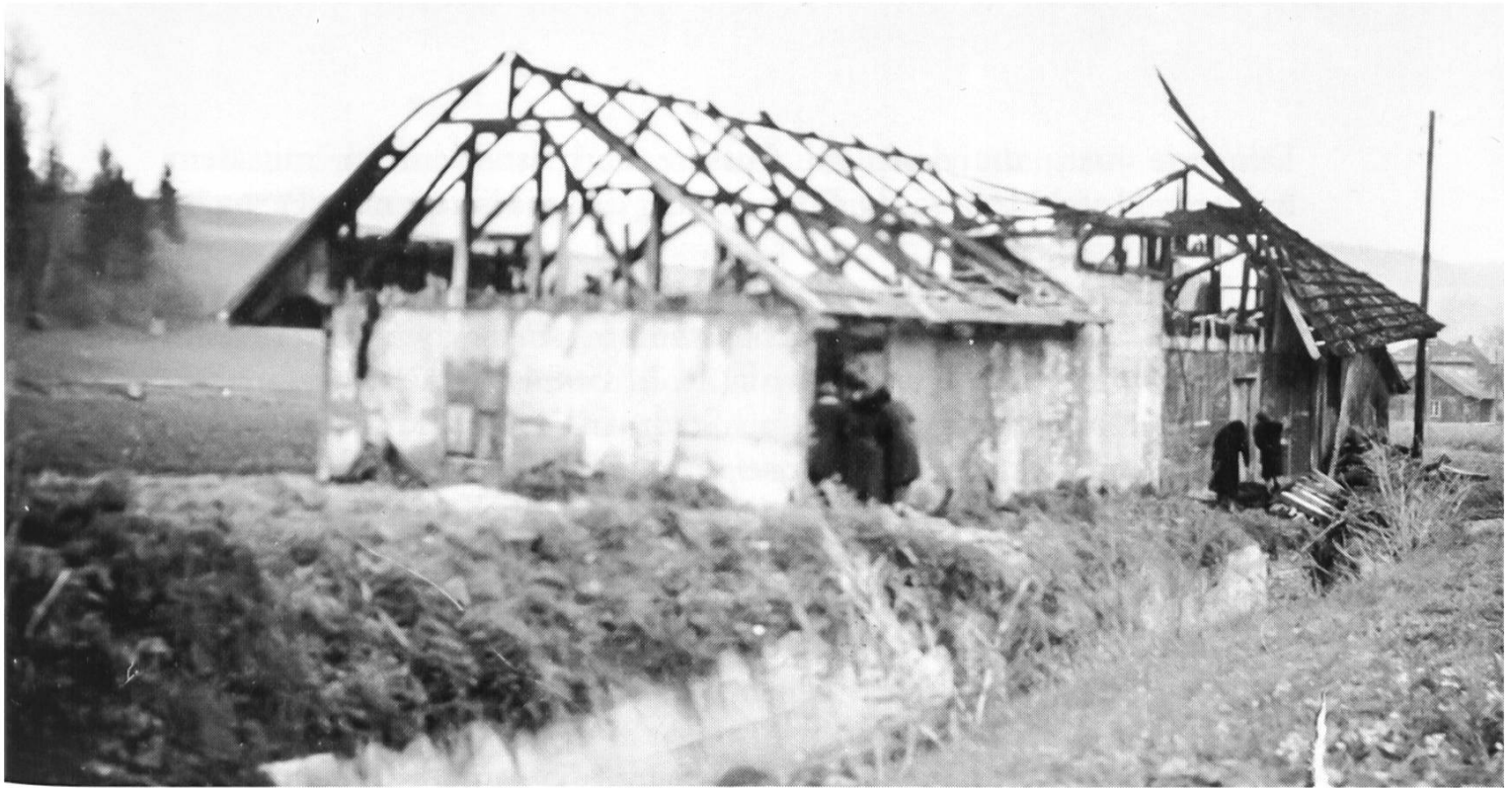
Das «Stampfeli» in Willisau-Land, zwischen Buchwigger (rechts) und Menzbergstrasse gelegen. Aufnahme von Süden, nach dem Brand vom 11. Mai 1941.
